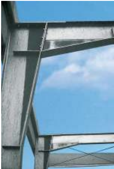
Abb. 16: Rahmenkonstruktion mit unterschiedlich ausgeprägten Zinkschichten
