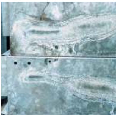
Abb. 27: Weißrostbefall infolge mangelnder Luftzirkulation
